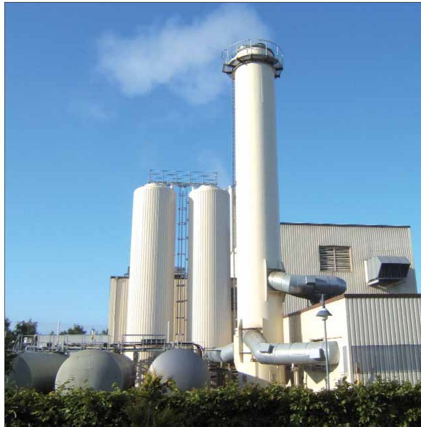
Bild 2. Die KWK-Anlage nach dem Umrüsten auf einen wirtschaftlichen Betrieb
