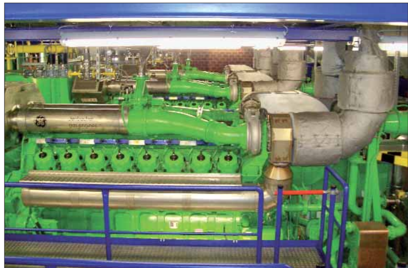
Bild 3. Die neuen Gasmotoren erhöhen die elektrische Gesamtleistung auf knapp 14 MW
